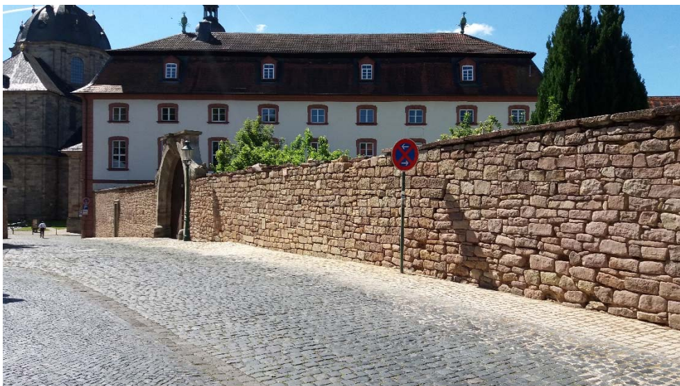
Blick nach Süden in Richtung Dom/Theologischer Fakultät, die Bestandsfugen sind ausgearbeitet, Teile der Mauerkrone abgenommen.
