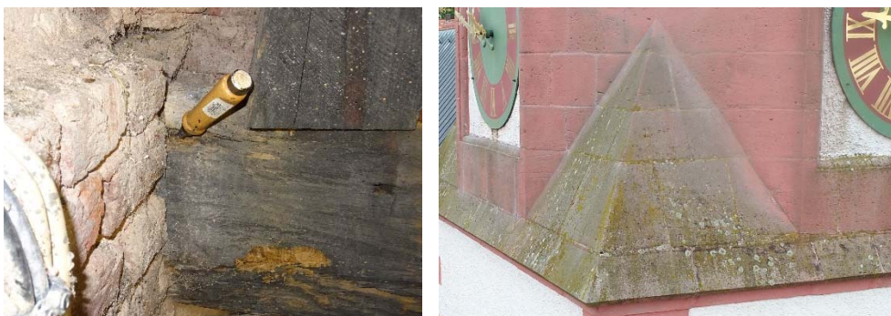
Links: geschädigter Balkenkopf; rechts: Übergang vom quadratischen zum achteckigen Turmaufsatz.
