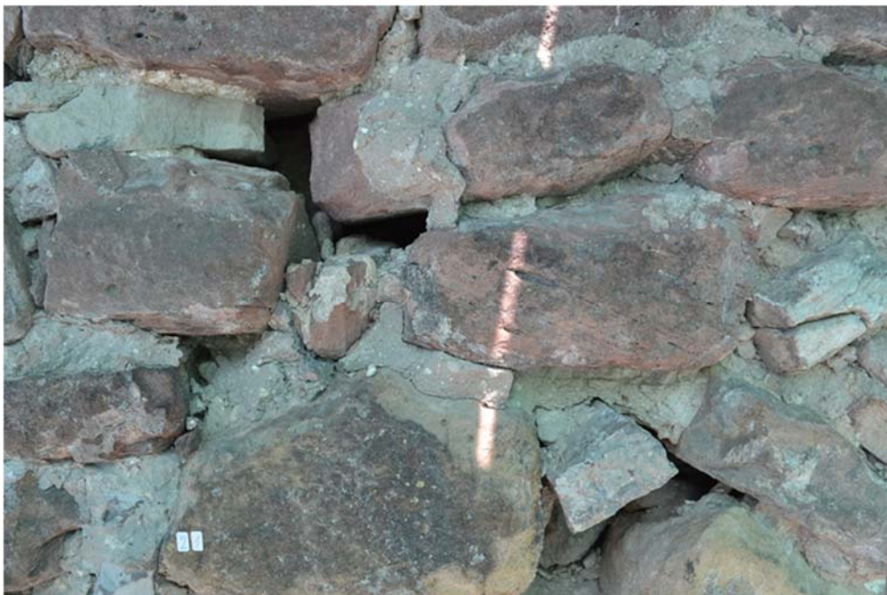
Stark geschädigtes, klüftiges Mauerwerk.
